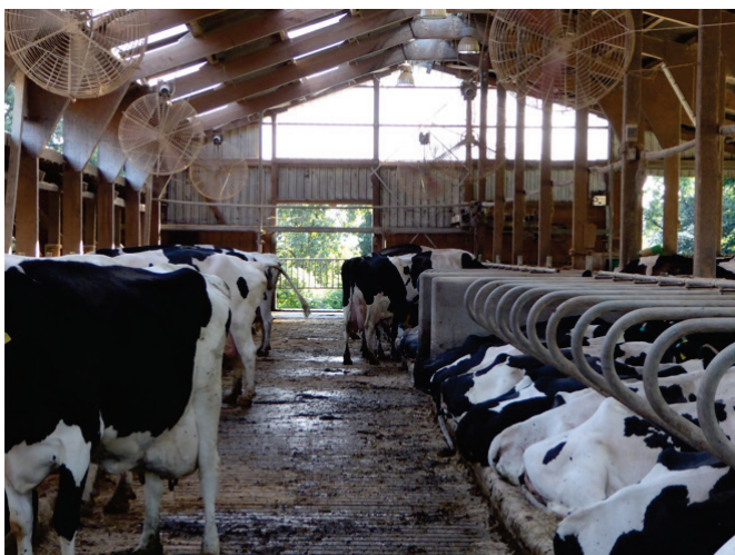
Axial-Ventilatoren über den Liegeflächen in Längsrichtung
