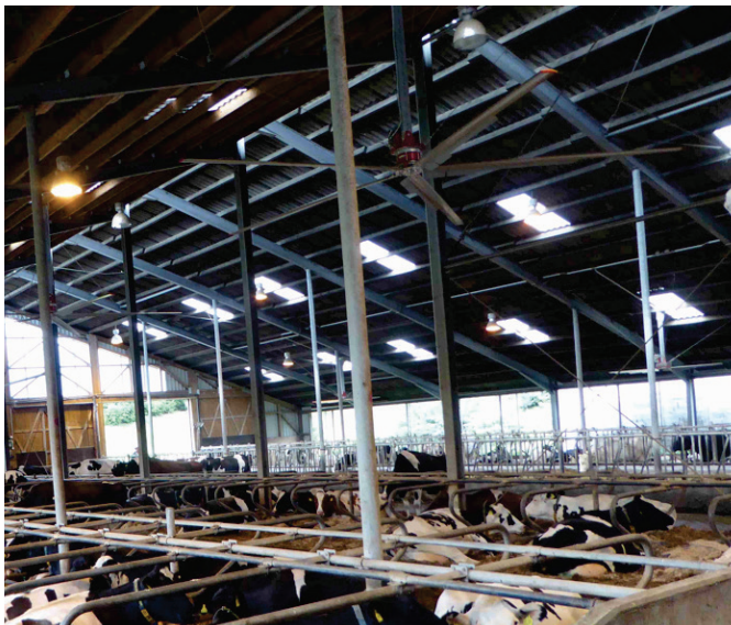
Radial-Ventilatoren über den Liegeflächen in Längsrichtung
